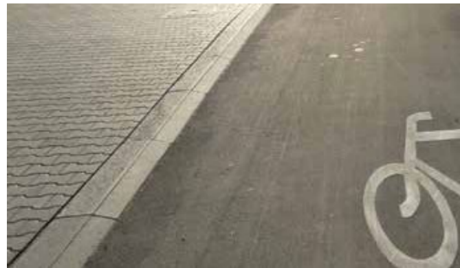
Zdjęcie 17 Obniżenie drogi dla rowerów względem chodnika przy pomocy krawężnika ułożonego „na płask”. Wrocław, Polska
