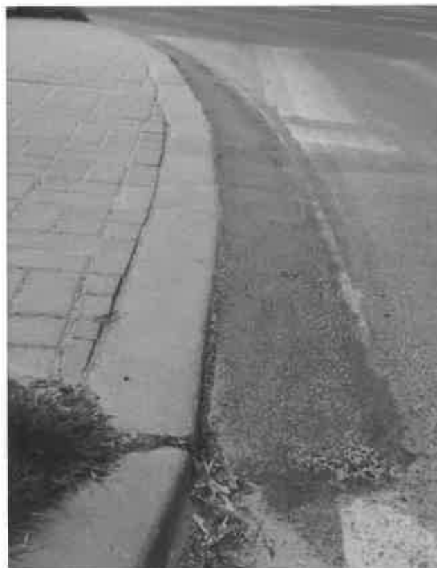
Zdjęcie 75 Wylewka z masy bitumicznej umożliwiająca wjazd na krawężnik - rozwiązanie tymczasowe. Wrocław, Polska
